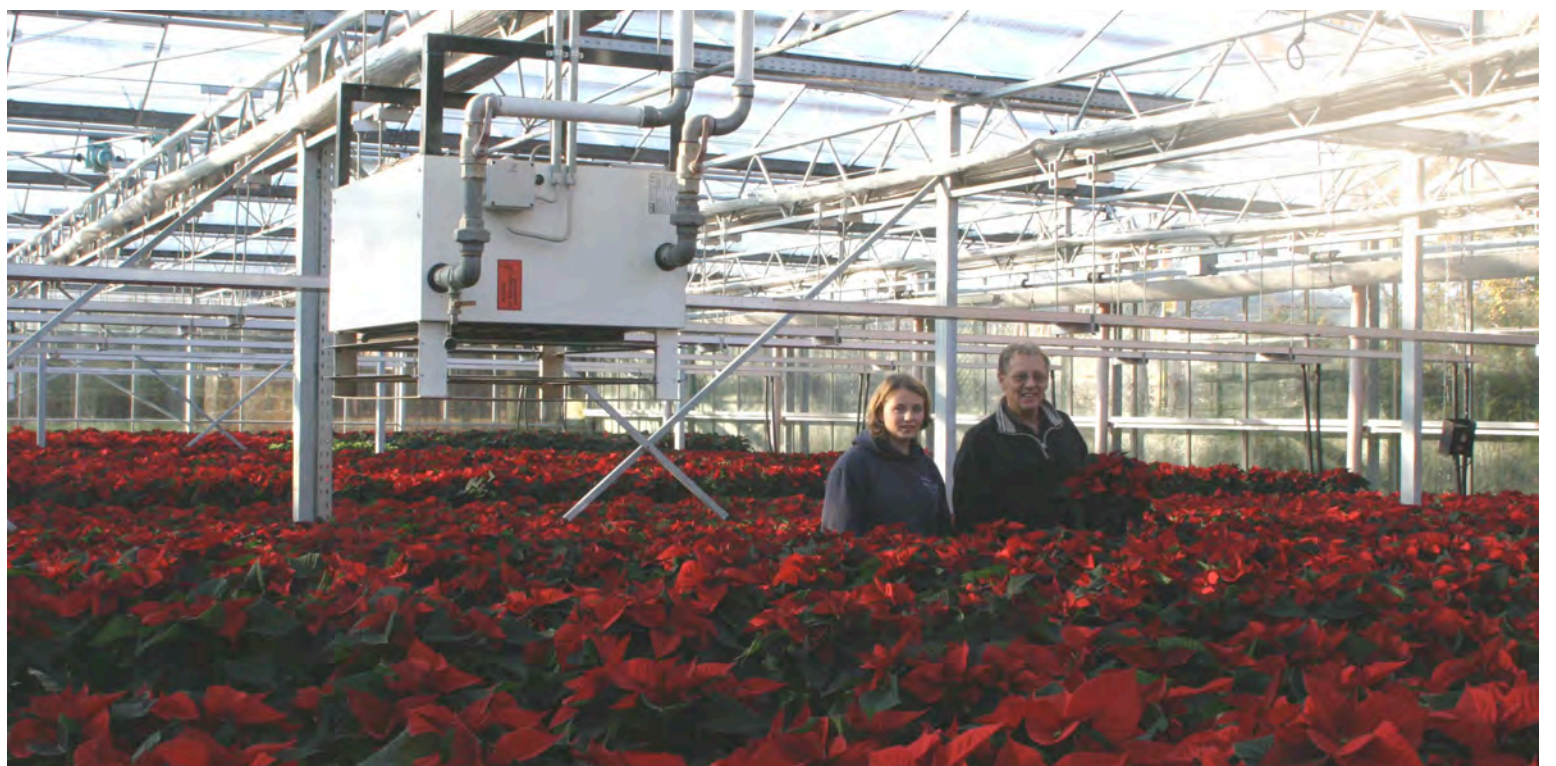
Weißer Kasten über roten Blüten – zwei dieser Lufterhitzer sorgen zur Zeit noch für die richtige Temperatur. Sie verteilen die Wärme im ganzen Gewächshaus. Demnächst soll aber auch hier eine Tischheizung entstehen, die effektiver arbeitet und perfekt zum neuen Wärmesystem passt.
